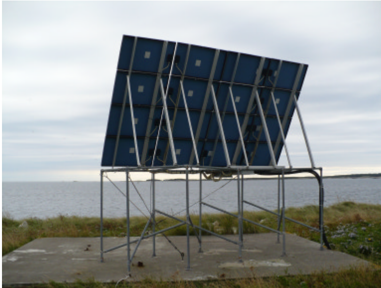
Figure 1e : Panneaux solaires montés sur une dalle de béton
