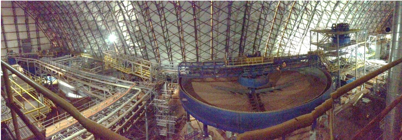
Débourbeur – Thickener Area
