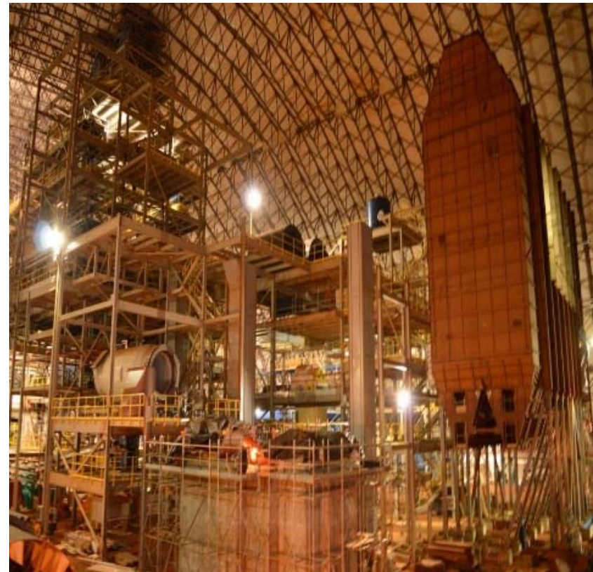
Équipement de traitement (Juin 2015) – Process Equipment (June 2015)
