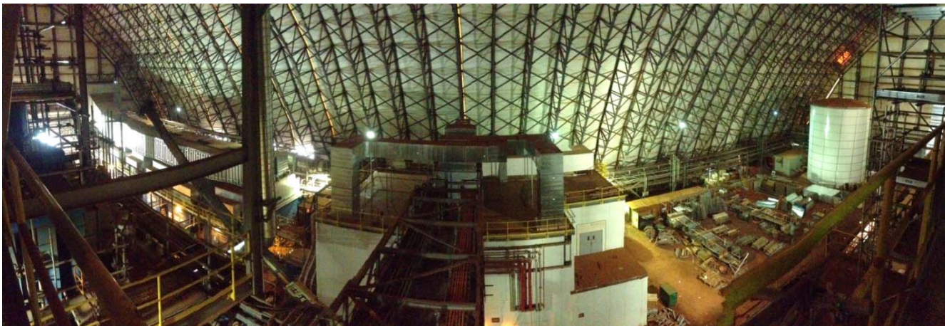
Salle électrique et Generatrice – Gensets + E House + Fire Protection Area
