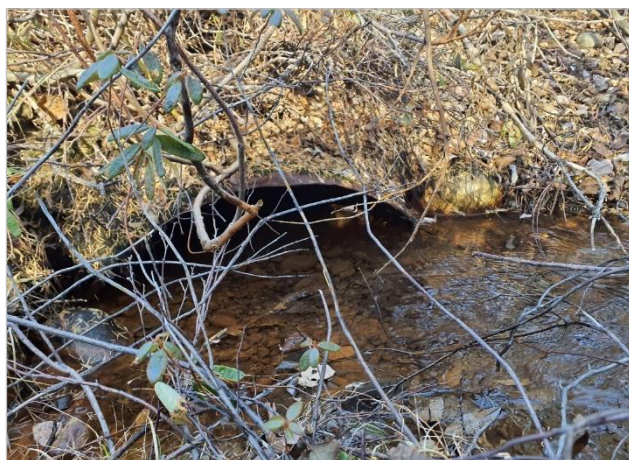
Photo 1. Ponceau bouché en quasi-totalité
