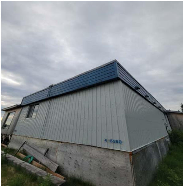
Photo 13. Photographie du 9 e bâtiment inspecté dans l'aire d'étude à la recherche de traces de présence de chiroptères cavicoles. Potentiel jugé nul.
