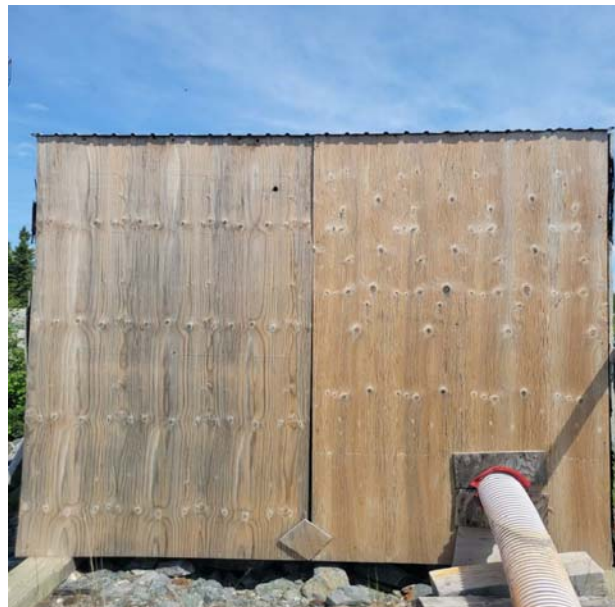
Photo 28. Photographie du 24 e bâtiment inspecté dans l'aire d'étude à la recherche de traces de présence de chiroptères cavicoles. Potentiel jugé faible.
