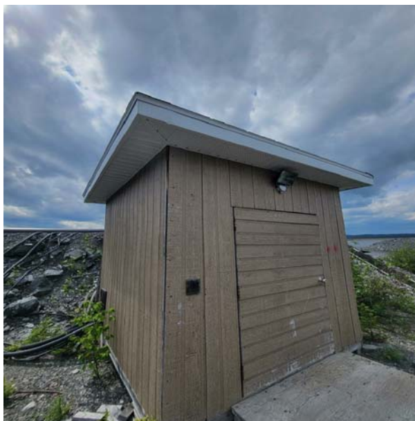
Photo 31. Photographie du 27 e bâtiment inspecté dans l'aire d'étude à la recherche de traces de présence de chiroptères cavicoles. Potentiel jugé nul.
